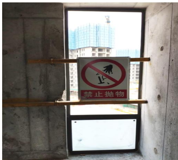
临边洞口防护实景图
